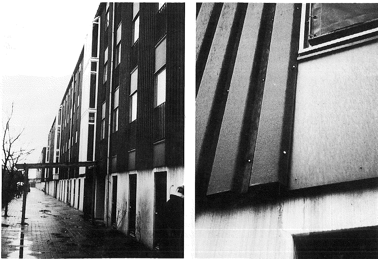
Figur 5 og 6. Tilstandsregistrering: Stålpladebeklædning på træskelet, og indbygning af snedkerparti. Stålpladerne op til 10 m lange, hvilket kan give en temperaturbetiget længdeændring på godt 1 cm.
