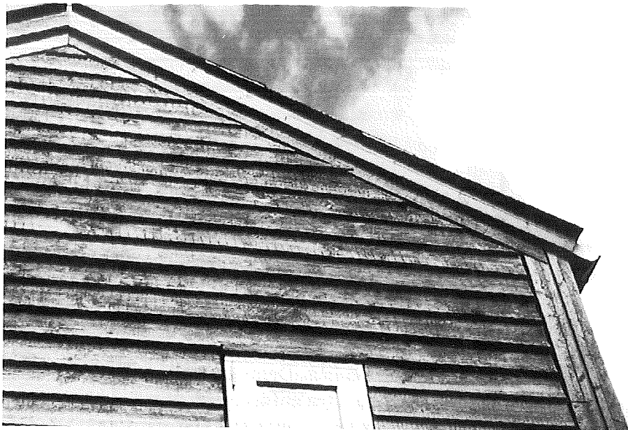
Figur 72. Tilstandsregistrering: Befæstelsessvigt i bræddebeklædningen.
