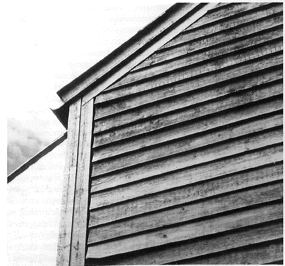
Figur 75. Tilstandsregistrering: Revne udgået fra endetræ i bræddebeklædningen.
