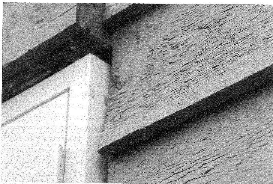
Figur 73. Tilstandsregistrering: Krumning af bræddebeklædningen.
